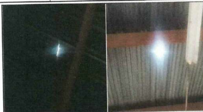
Foto 2: Se observa deterioro y perforaciones de las láminas del edificio educativo
