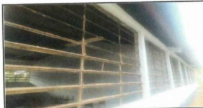
Foto 6: Se observa deterioro y oxidación de balcones de las tres aulas del edificio No. 1
