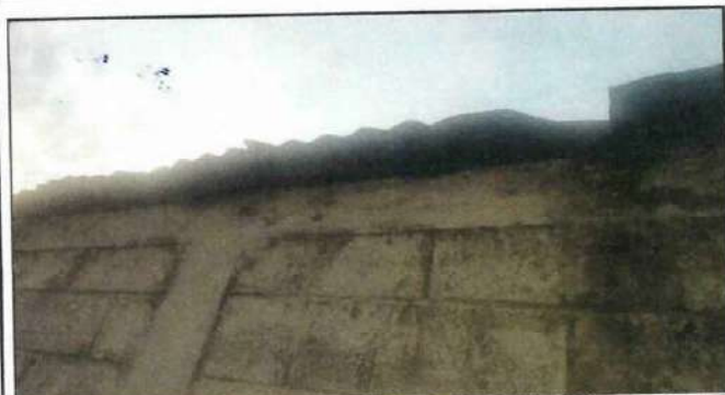
Foto 3: Se observa deterioro de las paredes
